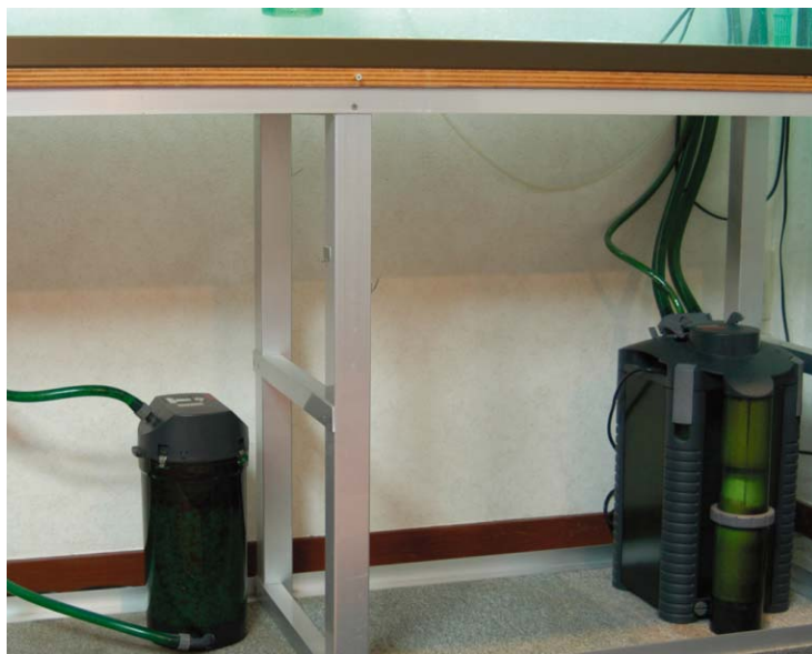
2229も2213も、ともにメンテナンスが容易に行なえるよう、水槽下の広いスペースにゆったりと設置されています。
